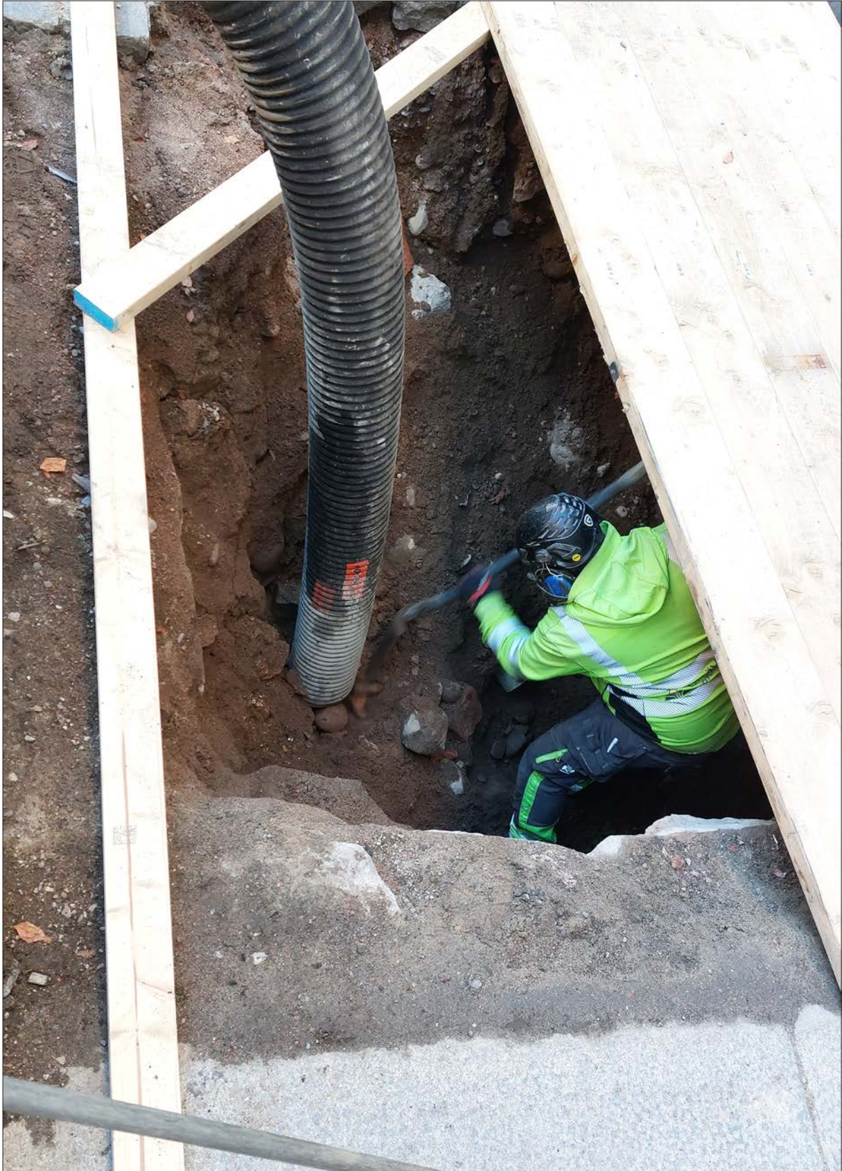
Figur 9. Schakt 2 från norr. Återfyllnadsmaterialet (13) i de befintliga ledningsgravarna var instabilt. I bild syns slangen till sugbilen som suger bort massorna. I fotots nedkant syns stödmuren (2) för en av trapporna och till vänster anas de översta stenarna i stödmuren (4) för källarbyggnaden.
