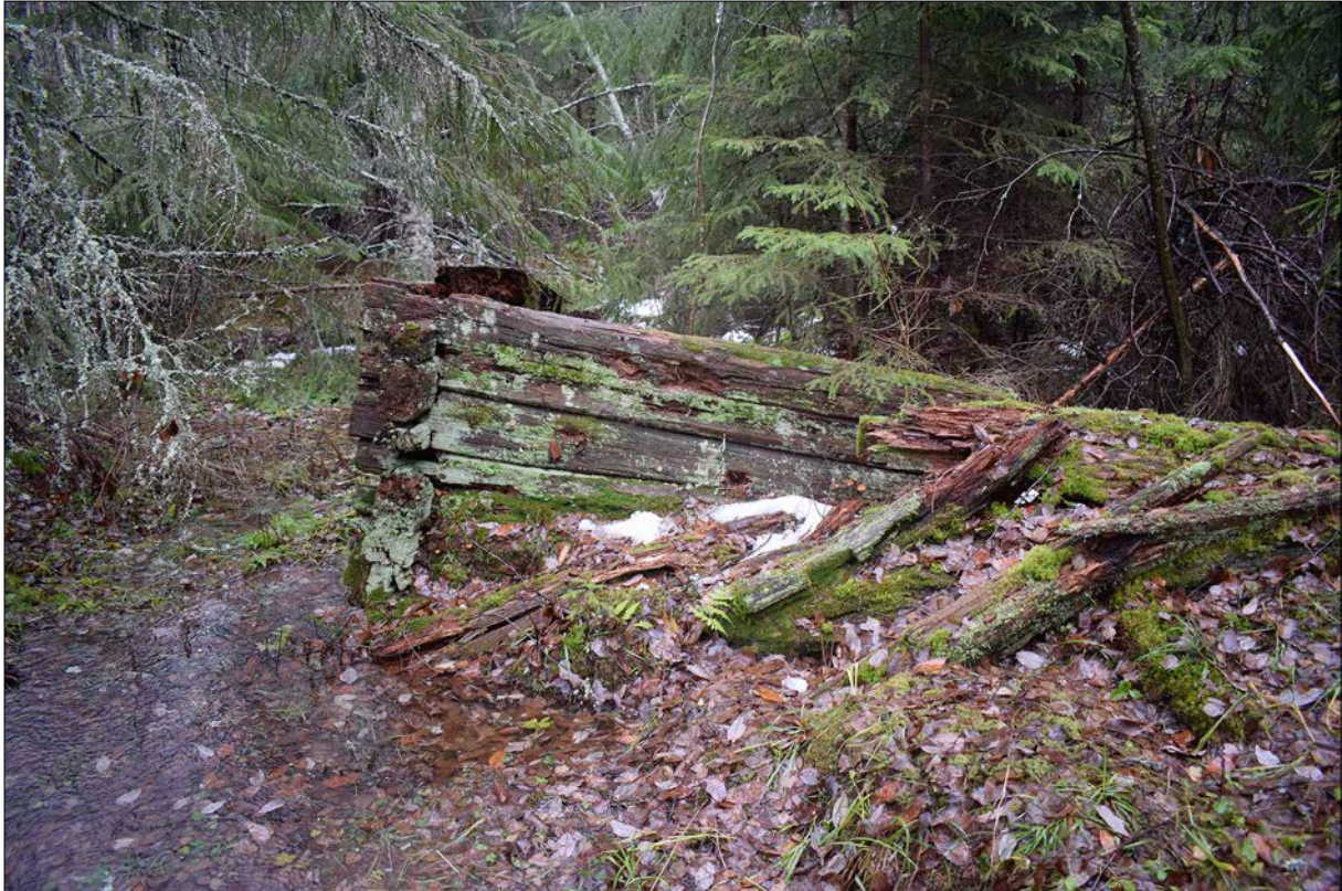
Figur 18. Den kvarvarande träkonstruktionen inom Håckstavallen var i mycket dåligt skick. Här kan även de dåliga väderförhållandena skymta till vänster.
