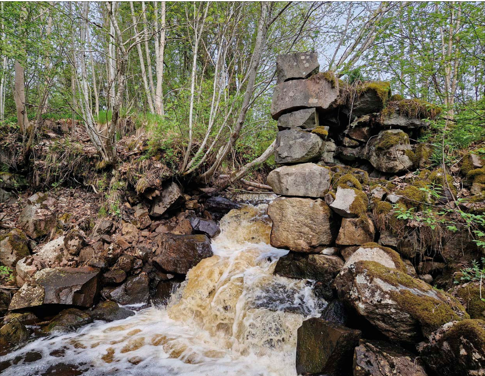
Figur 20. Dammvallen och stenfundamentet vid utskovet är i dåligt skick. Foto från sydost.
