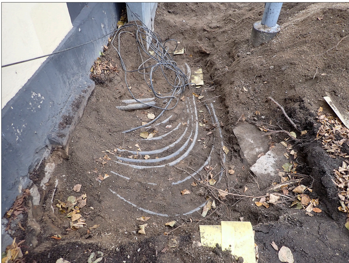
Figur 7. Ledningar och elskåp vid den norra stenboden i schakt två. De stenar som framkom i schaktet (kontext 101) syns här i nedre högra hörnet. Stenarna lämnades in situ efter avslutad schaktning. Foto taget från söder.
