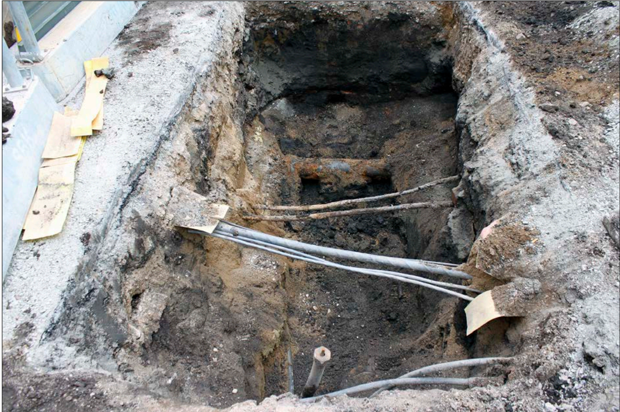
Figur 10. Schakt 6 med ledningar och rör som gjorde schaktningen svår. Foto från norr.
